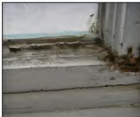
État des fenêtres
